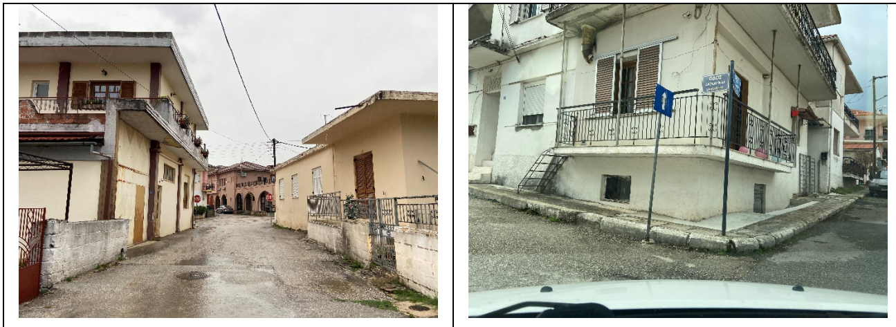
Απουσία πεζοδρομίων ή ύπαρξη πεζοδρομίων κακής ποιότητας με εμπόδια και περιορισμένη διαστασιολόγηση
